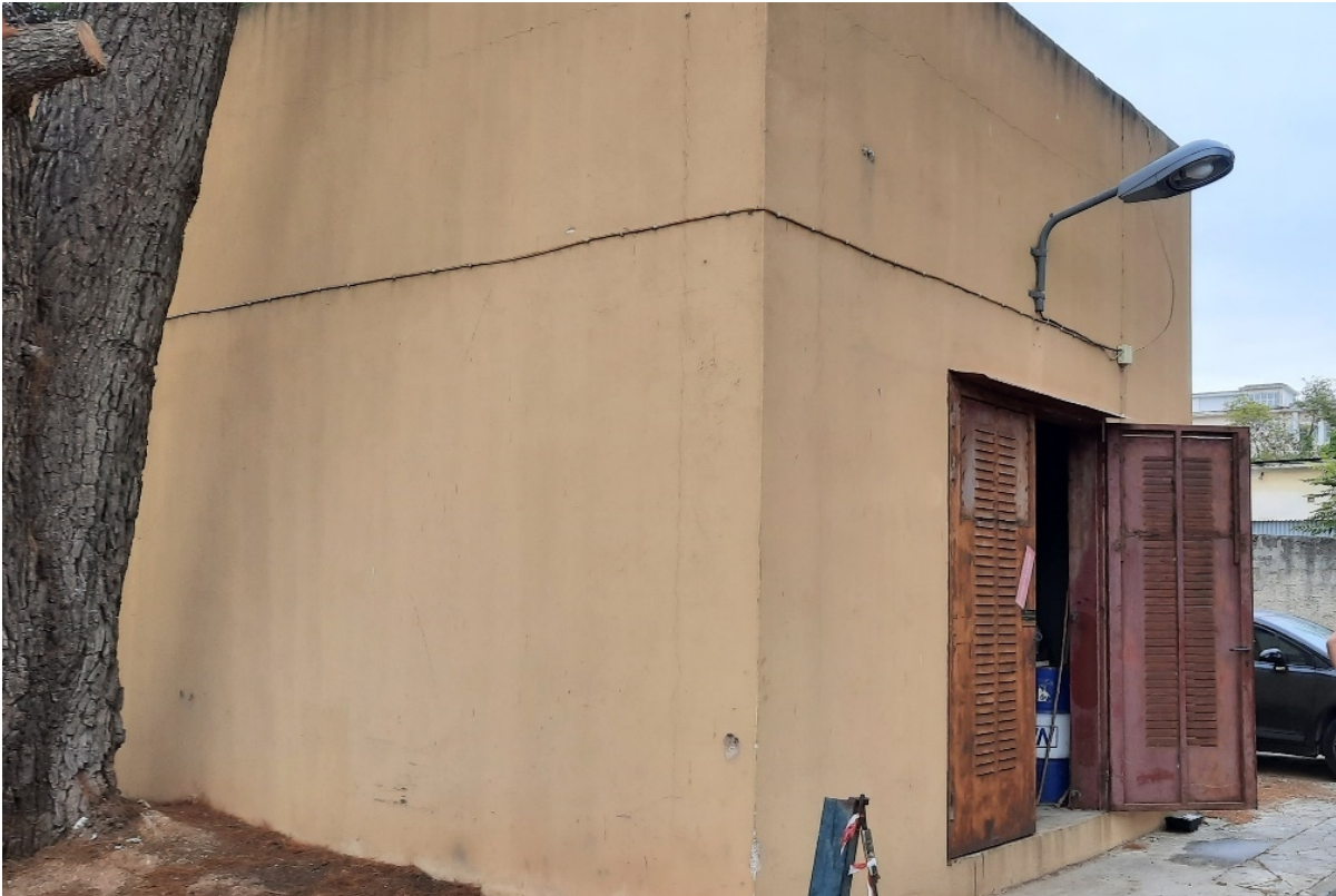
Εικόνα 6: Θύρα χώρου Η/Ζ 625KVA που απολεξώνεται
