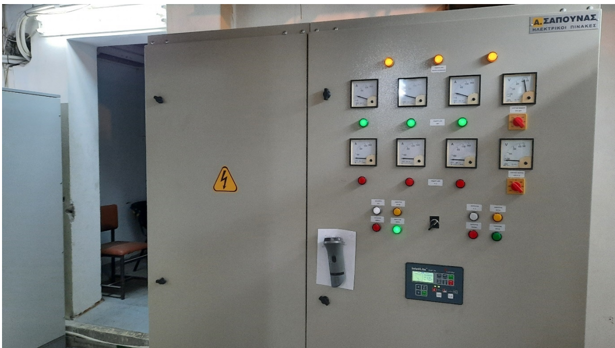
Εικόνα 3: Υφιστάμενος Αυτόματος Μεταγωγικός Διακόπτης (Α.Μ.Δ.) και Γενικός Πίνακας Ανάγκης
