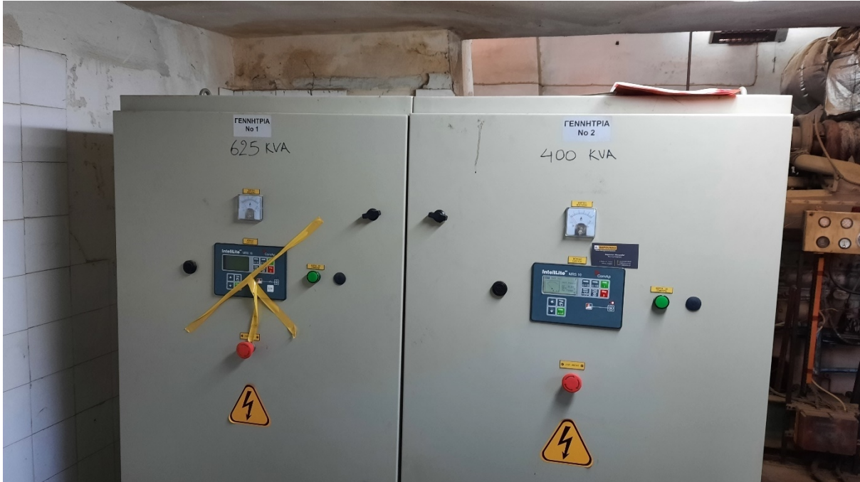
Εικόνα 2: Υφιστάμενος πίνακας εναλλαγής λειτουργίας των Η/Ζ που αποξηλώνεται.
