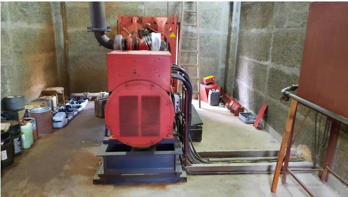
Εικόνα 1: Υφιστάμενο Η/ζ 625KVA που αποξηλώνεται.
