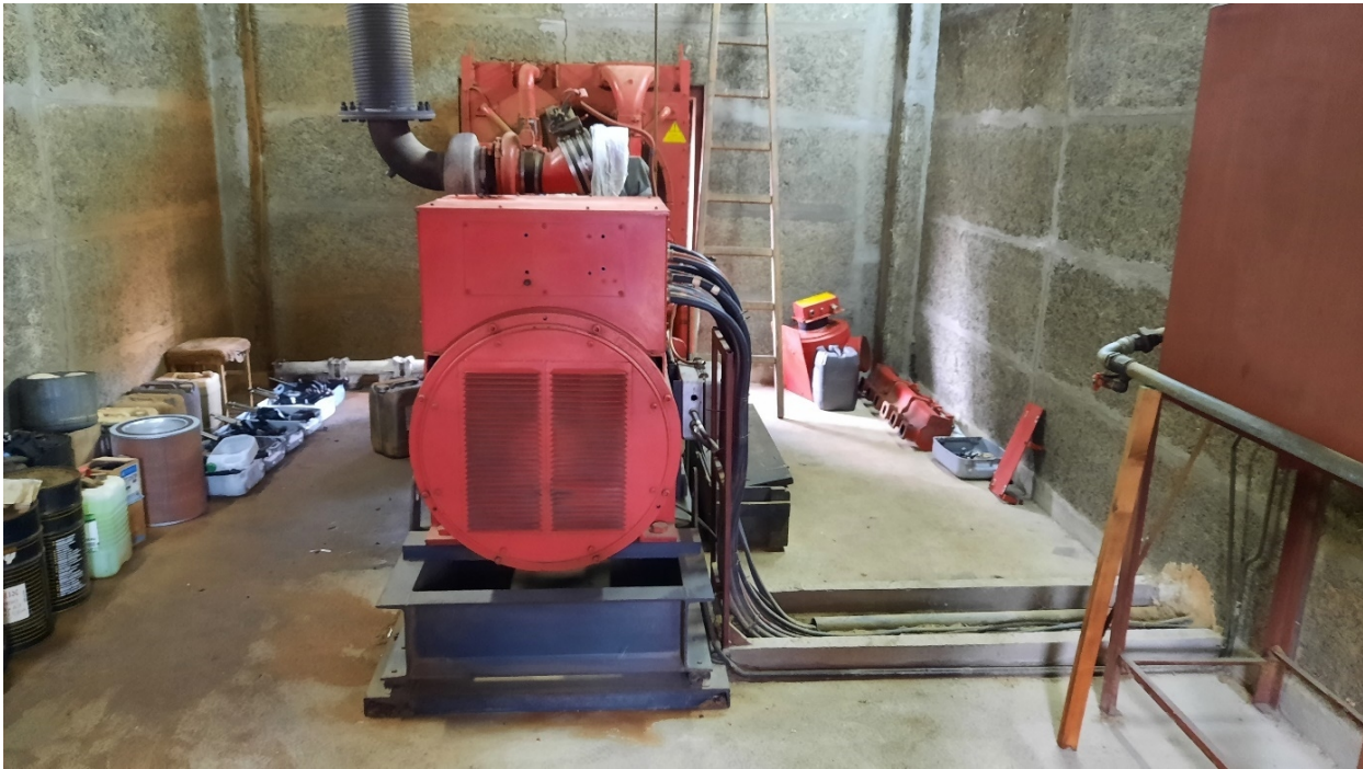
Εικόνα 1: Υφιστάμενο Η/Ζ 625KVA που αποξηλώνεται.
