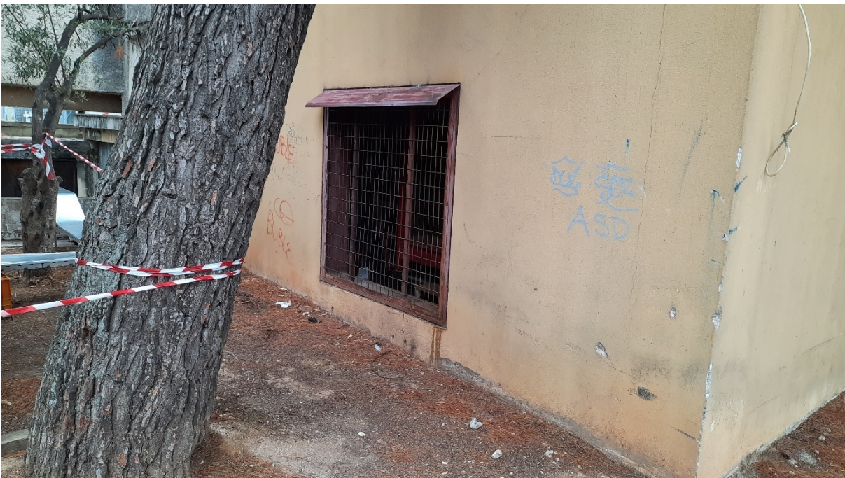
Εικόνα 5: Άνοιγμα αερισμού υφιστάμενου ΗΖ 625kVA.
