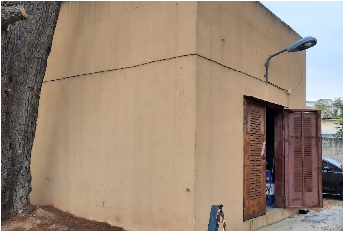
Εικόνα 6: Θύρα χώρου Η/Ζ 625KVA
