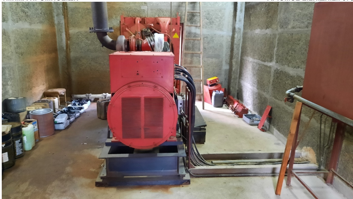
Εικόνα 1: Υφιστάμενο Η/ζ 625KVA που αποξηλώνεται.
