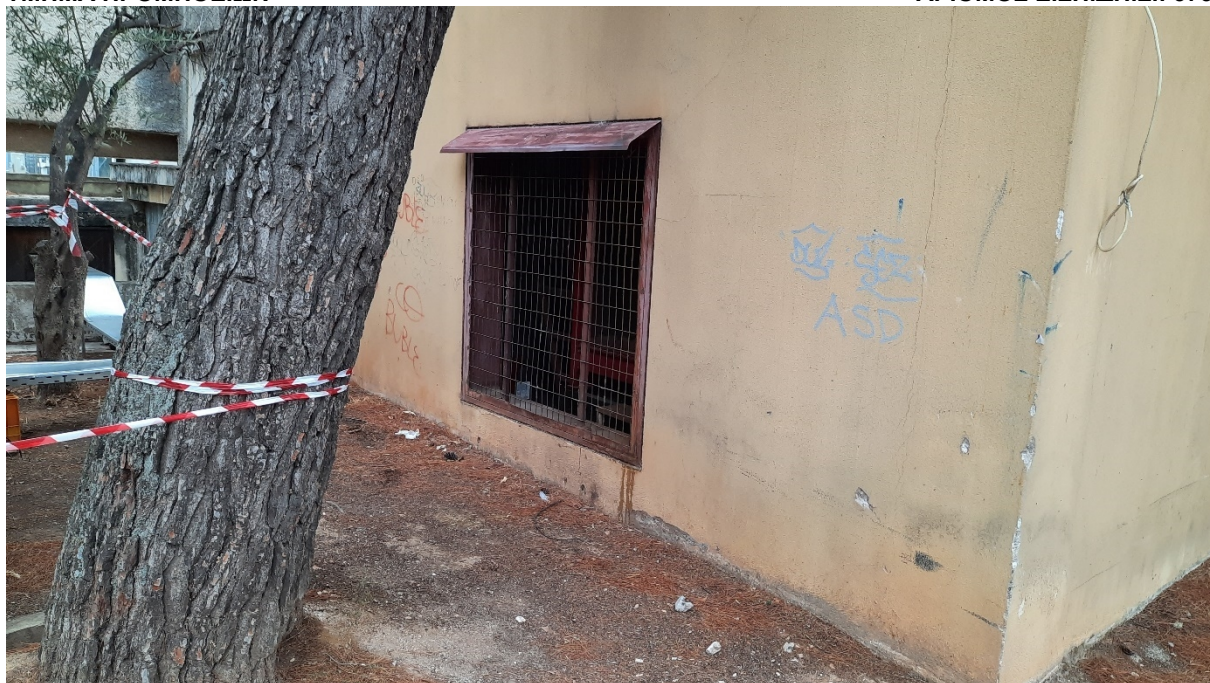
Εικόνα 5: Άνοιγμα αερισμού που διευρύνεται.
